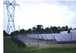
Şebekeye elektrik veren güneş pili (PV) sistemi
