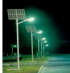
Güneş pilleri ile sokak aydınlatması
